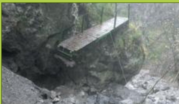
Passerella sospesa e la frana dopo l'alluvione
